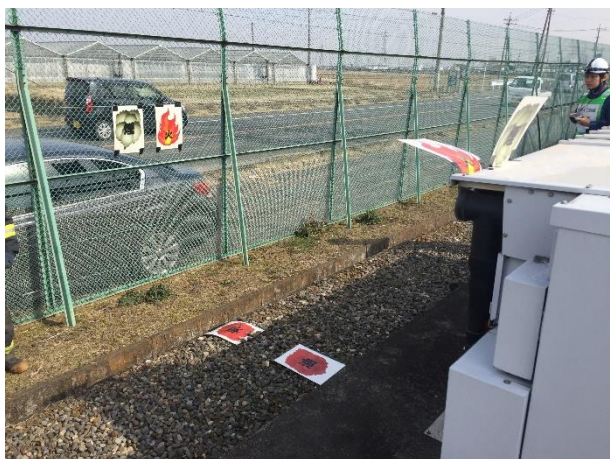
火災発生状況
